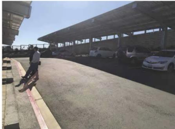
Figura 36 - Vista do estacionamento coberto com placas solares da Valley View Senior Housing
