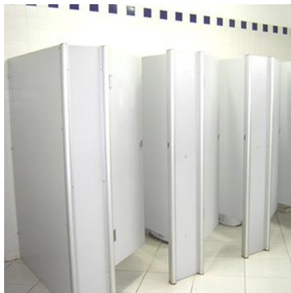
Figura 82 – Divisória de banheiro em material laminado
